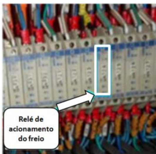
Figura 10 - Relé de acionamento do freio.
