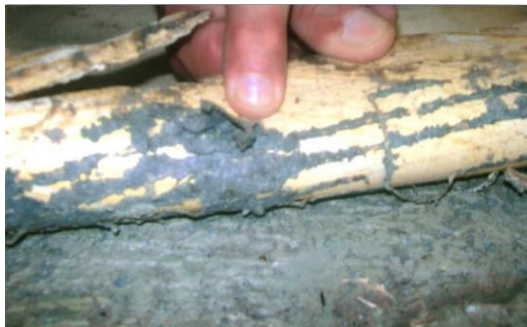
Figura 9: Contrapiso aplicado de forma incorreta
