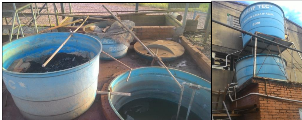
Figura 6: fase final do tratamento e armazenamento do efluente tratado
