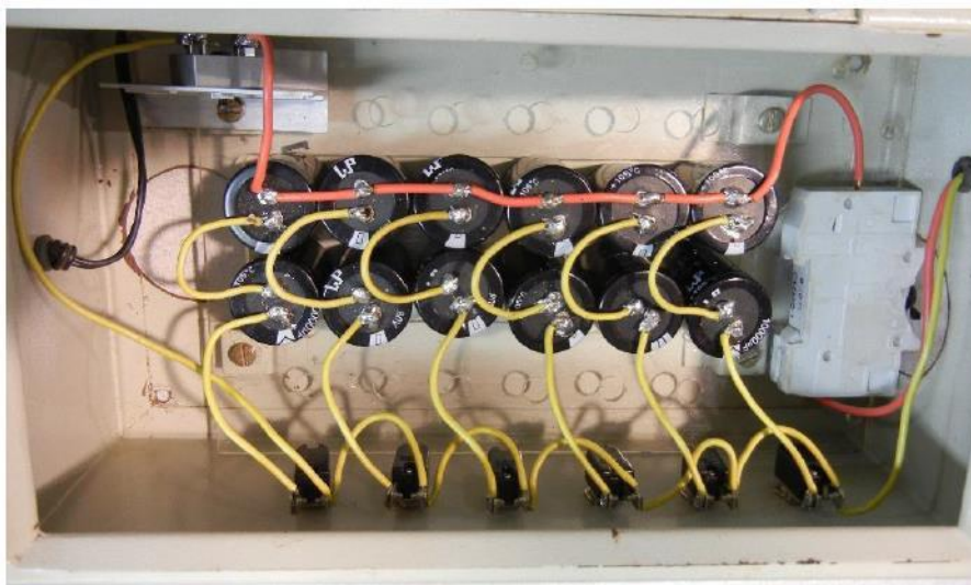
Figura 3. Interior da caixa de armazenamento dos componentes elétricos.
