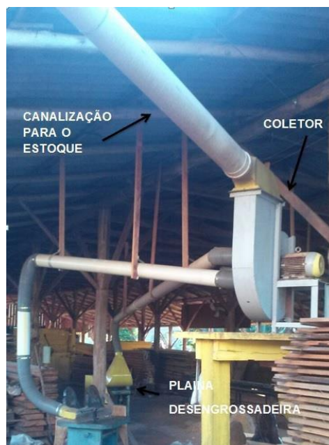
Figura 5 – Canalização do coletor até o depósito para estocagem.
